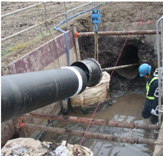
Буровой канал расширен до Ø 800 мм. Теперь может быть втянута новая труба Ø 560 мм.
