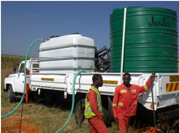
Буровой раствор смешивается в баке объемом 4 000 (белый). Объем раствора в зеленом баке - 6000 л.
